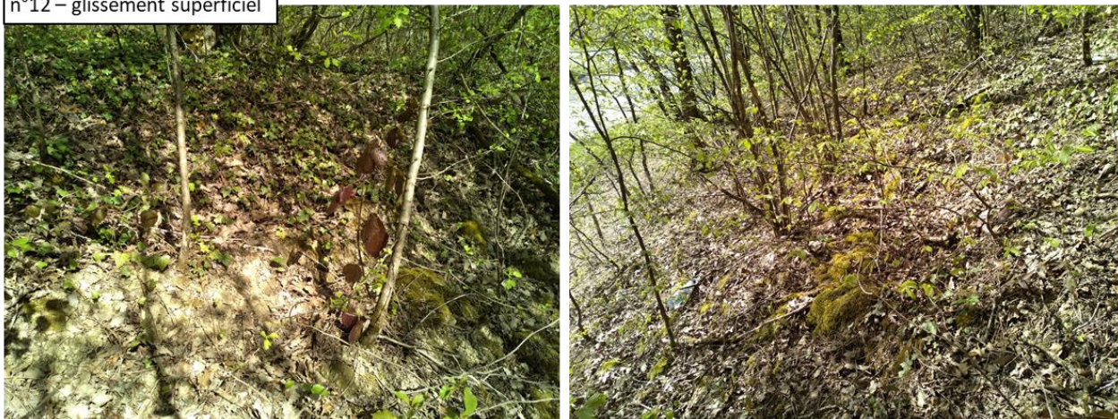
Illustration 18 : Photographie d'un glissement superficiel (n°12) affectant un talus sur la commune d'Hagondange
