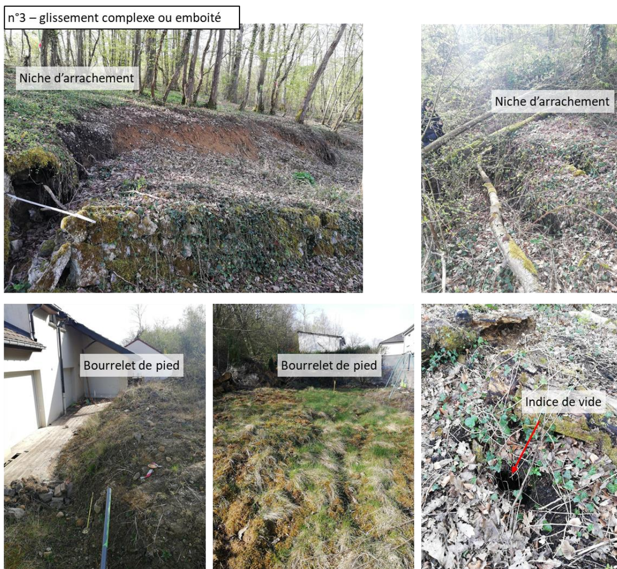
Illustration 13 : Photographies du glissement de terrain n°3 présentant des niches d'arrachements, des bourrelets de pied et un indice de vide
