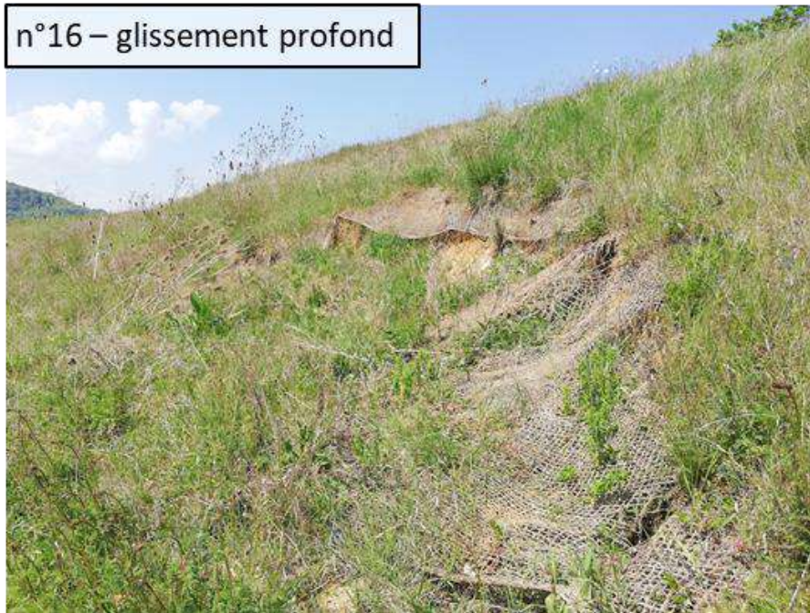
Illustration 19 : Photographie du glissement profond (n°16) affectant un talus routier
