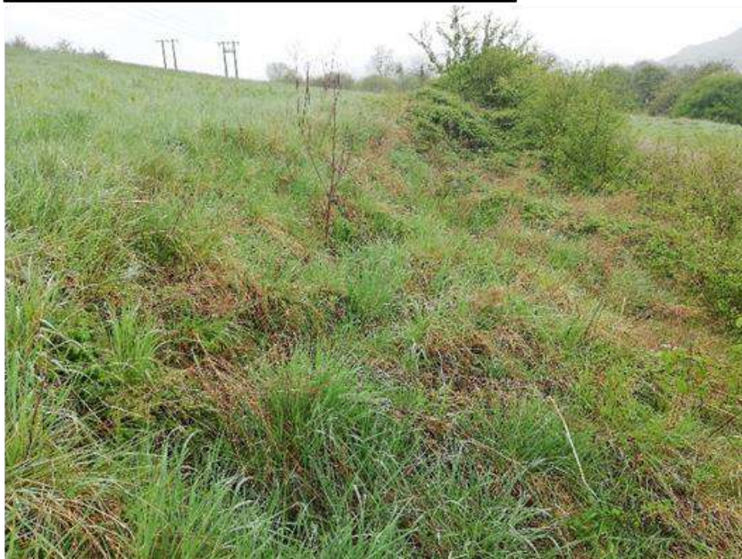
Illustration 20 : Photographie d'un glissement superficiel ancien (n°17) affectant un talus localisé
